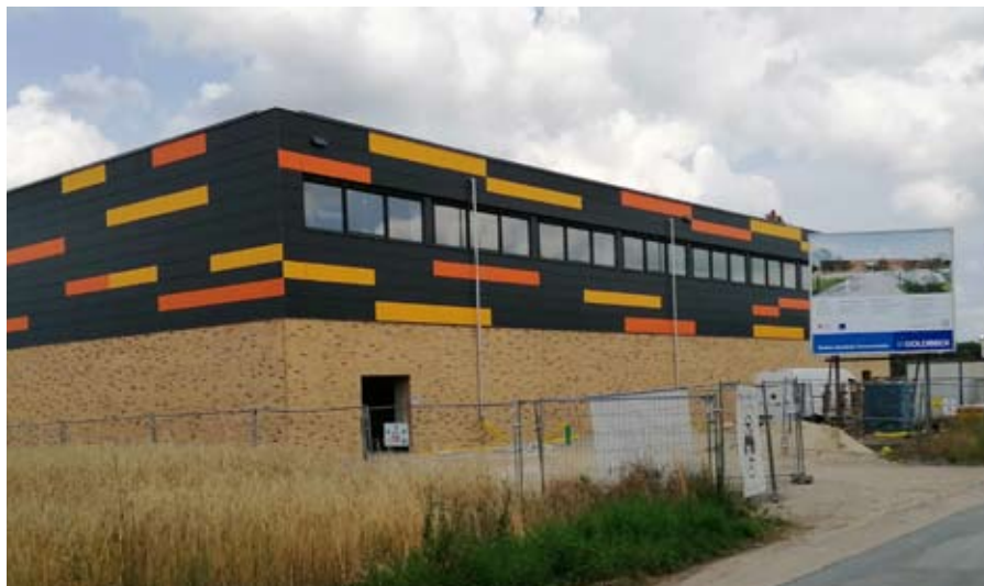
In der Chausseestraße entsteht das neue große „Sportzentrum Sehnde“, so lautet der offizielle Name für die großen Hallen. Gebaut werden eine Vierfeld- und eine Zweifeldhalle.
