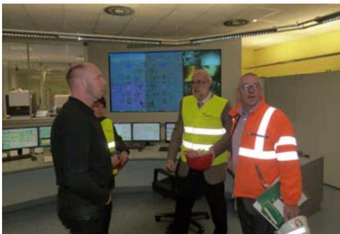
Im zentralen Leitstand: Prozesssteuerer Ralf Lenekamp erläutert Silke Lesemann und Detlef Tanke die Steuerung und Überwachung der Produktionsanlagen, rechts Bernd-Henning Reupke.
